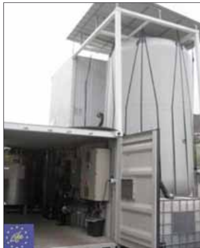
Fig. 2. Vista general de la planta de digestión anaerobia y de la bolsa de biogás
