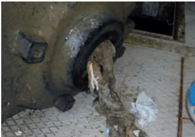
Restos de toallitas en nuestras tuberías
