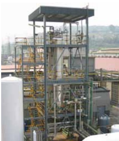
Planta LOPROX de oxidación de compuestos aromáticos
