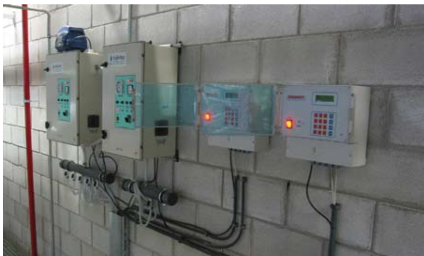
Instalación de generadores de ozono
